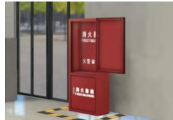
消防柜内无灭火器
